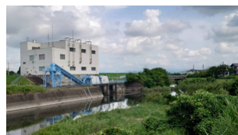
荒田川・論田川第二排水機場
